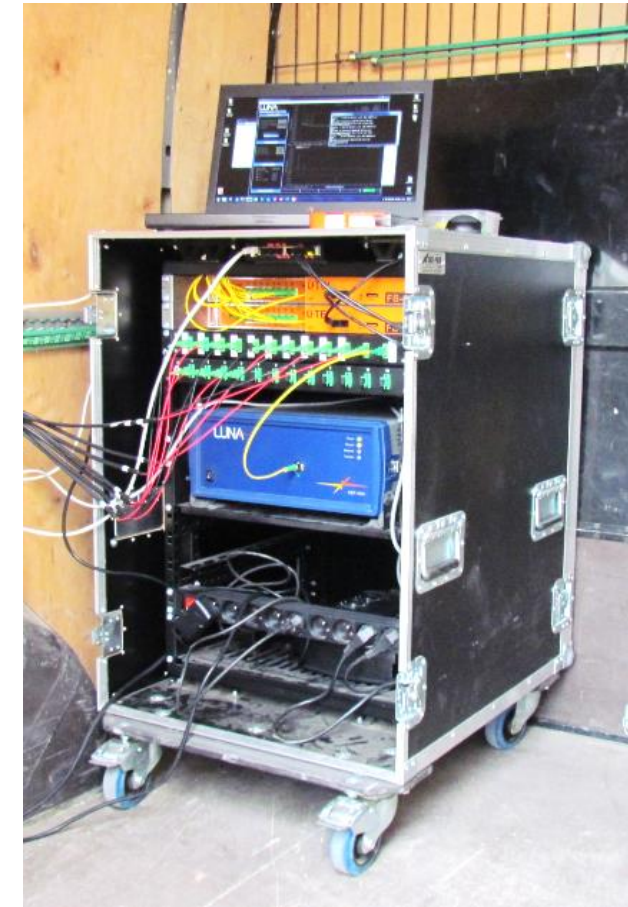
Rack de mesure
