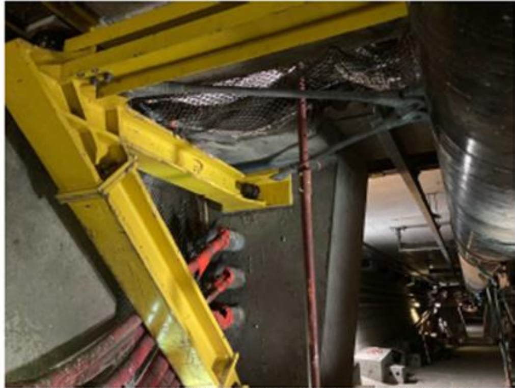
Figure 17 Chèvre métallique installée au niveau du cantilever V1/V2
